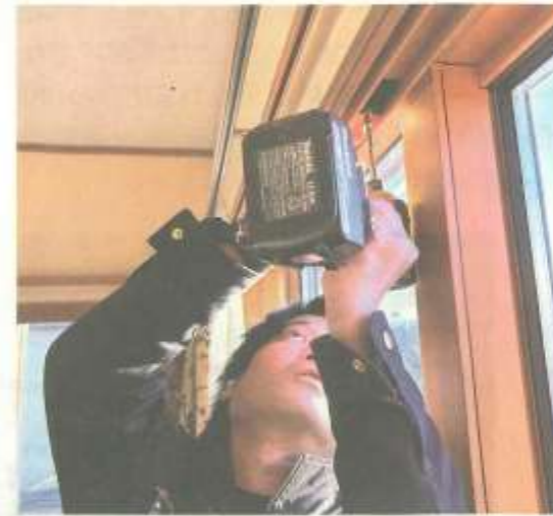
内窓を施工するクリアのスタッフ。内窓設置は簡単に作業でき、補助金の対象にもなる
